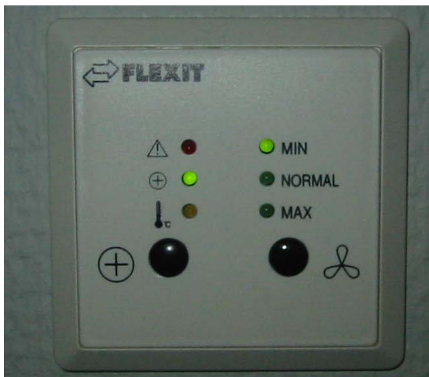
Figur 1: Styringsenhet for ventilasjonsanlegget.
