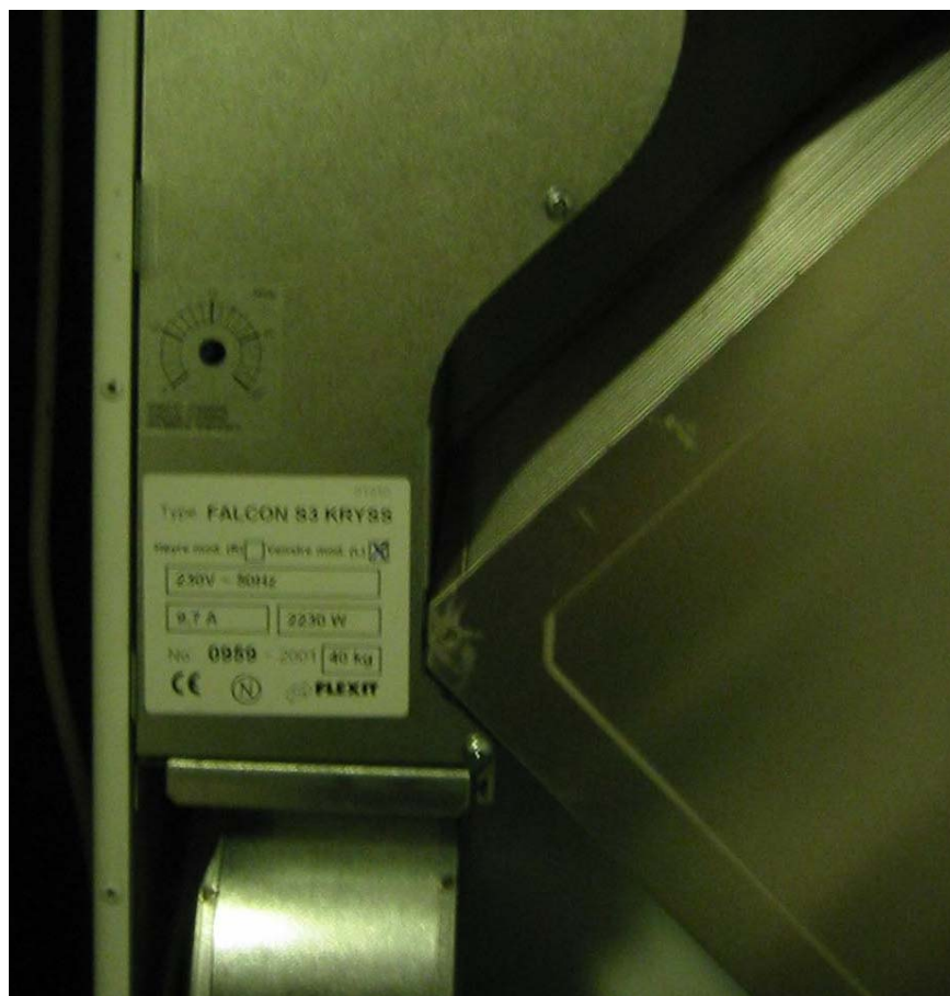
Figur 2: Termostat for tilleggsvarme er plassert rett over merkelapp (til venstre på bildet).
