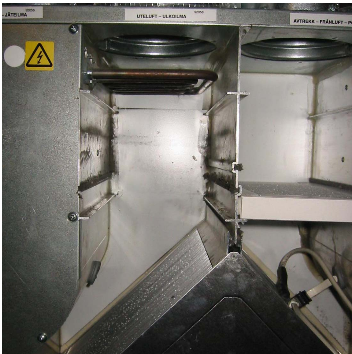
Figur 11: Kanal for uteluft etter at filtrene er fjernet. Øverst er varmeelementet.
