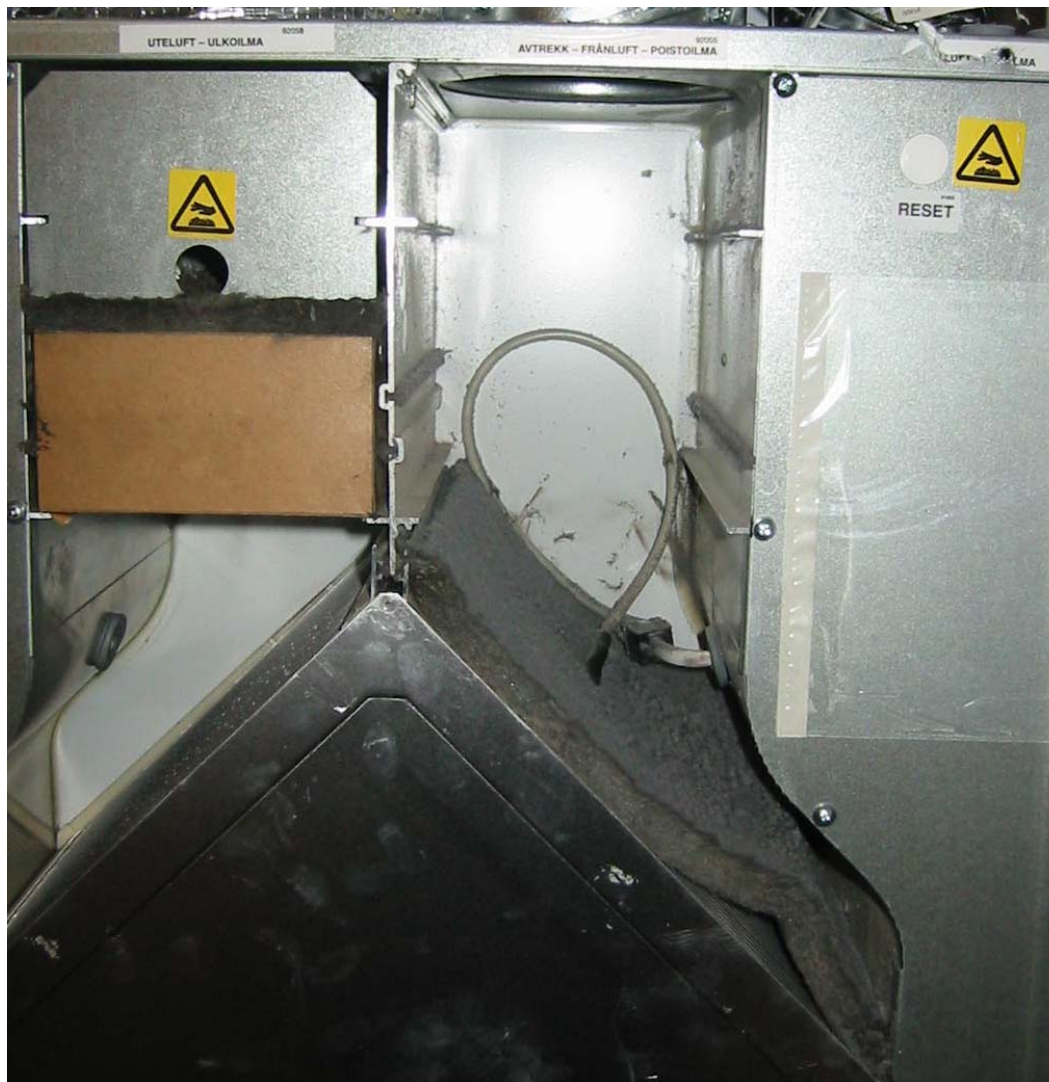
Figur 8: Termofuktføler og gammelt planfilter for avtrekksluft midt på bildet.
